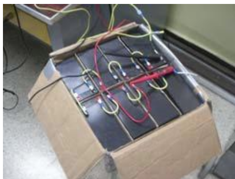
Figura 4: Banco de Baterías
