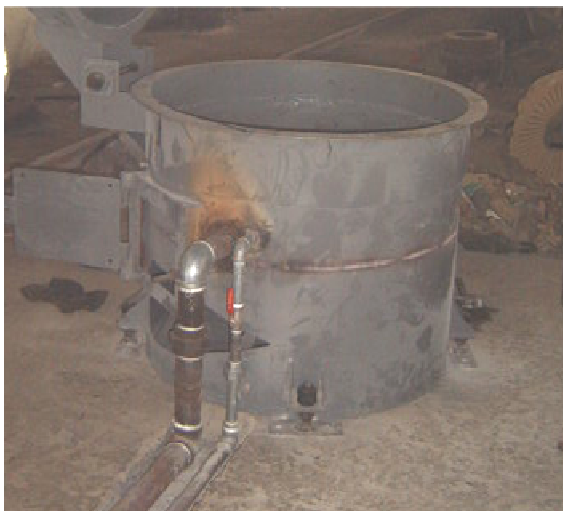
FIGURA 2.48 TUBERÍA DE ALIMENTACIÓN Y DRENAJE DE AGUA
