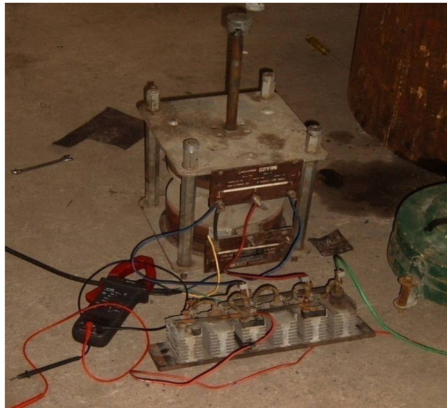
FIGURA 2.52 REÓSTATO Y RECTIFICADOR INDUSTRIAL QUE SE UTILIZÓ.
