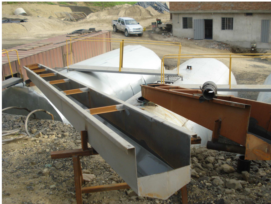
Fig. 4.1.2 – Contenedores de Cemento Asfáltico
