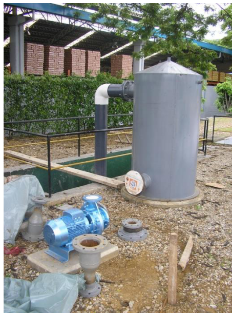
Pozo de bombeo a Tanque Anoxico
