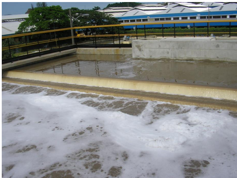
Tanque Anóxico alimentando a Tanque de Aireación
