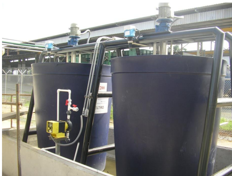
Cubeto de Polieléctrolitos con accesorios dosificadores.
