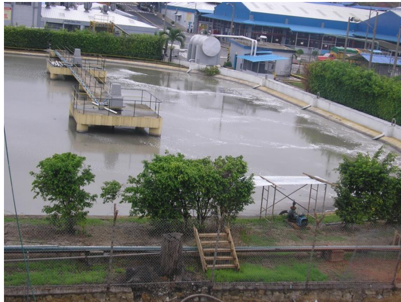
Laguna Anaerobia existente
