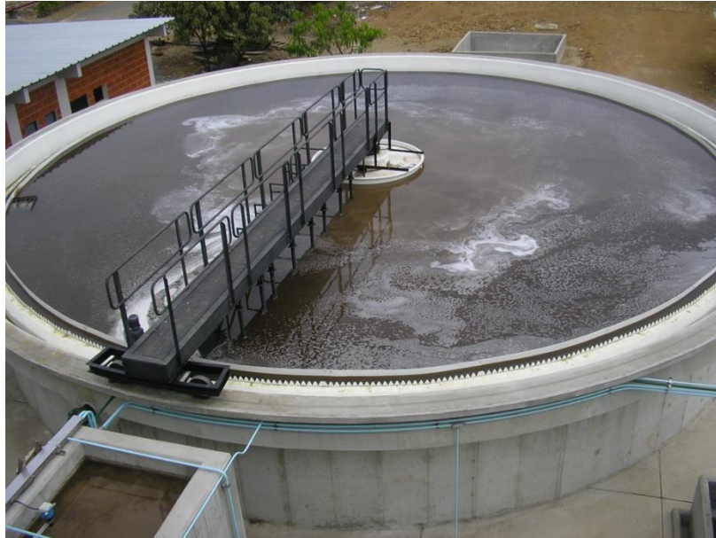
Decantador con puente Barrenador
