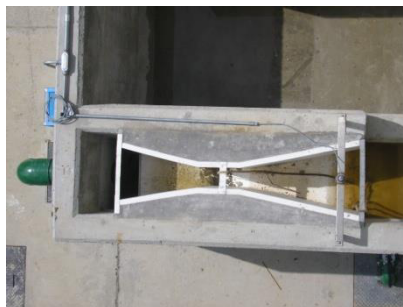
TRANSMISOR SENSOR DE CAUDAL EN CANAL PARSHALL DE SALIDA
