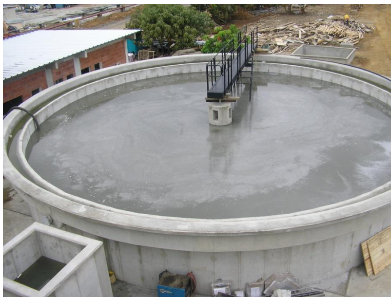
Decantador de lodos
