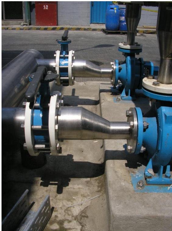
Bombas de Alimentación
