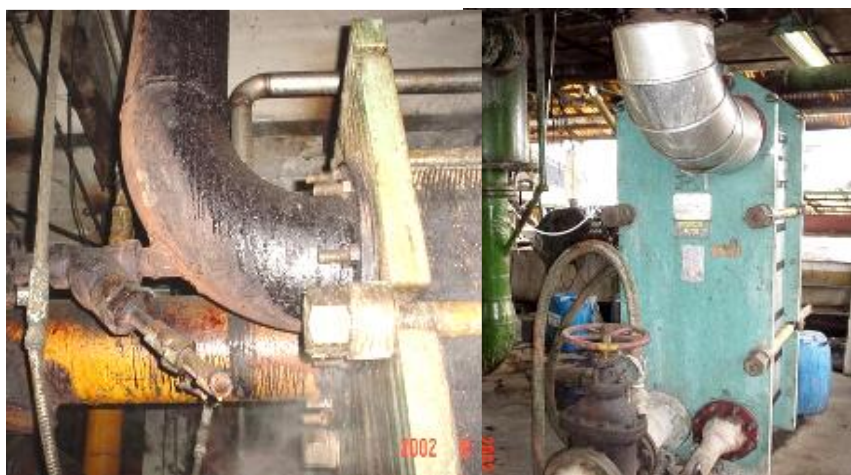
FIGURA 6.28 INTERCAMBIADOR DE PLACAS ALFA-LAVAL
