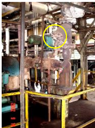
FIGURA 6.13 PURGA MANUAL INSTALADA EN UN FILTRO
