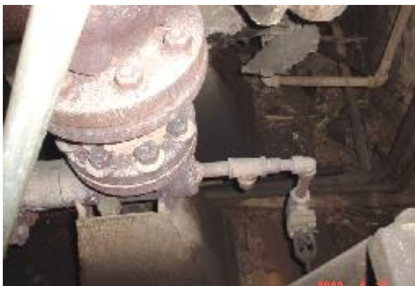
FIGURA 6.14 PURGA MANUAL INSTALADA EN LA PARTE LATERAL DE LA TUBERÍA DE INGRESO A LA TURBINA DEL PRIMER JUEGO DE CUCHILLAS
