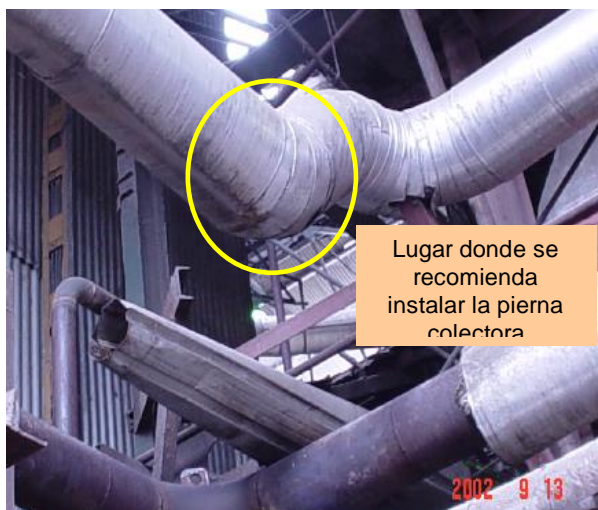
FIGURA 6.2 LÍNEA DE ALIMENTACIÓN TURBOGENERADOR ELÉCTRICO
