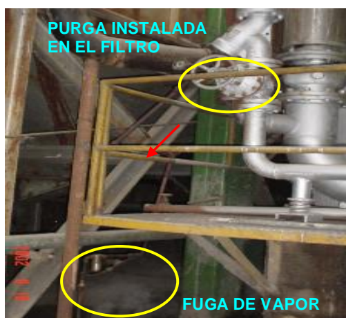
FIGURA 6.6 FUGA DE VAPOR A TRAVÉS DE LA TRAMPA DE VAPOR ABIERTA
