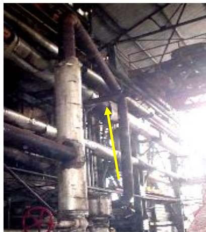
FIGURA 8.9 LÍNEA DE DESCARGA MOLINO # 2.SIN AISLAR
