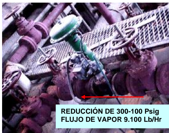
FIGURA 5.5 ESTACIÓN REDUCTORA DE PRESIÓN
