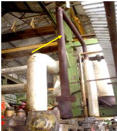
FIGURA 8.7 LÍNEA DE ALIMENTACIÓN DE LA TURBINA DESFIBRADOR SIN AISLAR
