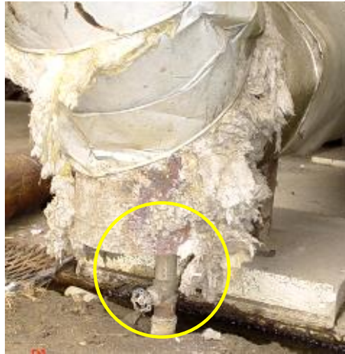
FIGURA 6.19 LÍNEA PRINCIPAL DE DESCARGA TUBERÍA \phi 20''
