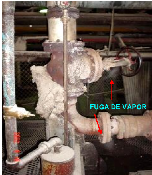
FIGURA 6.9 FUGA DE VAPOR A TRAVÉS DE LOS ACCESORIOS DE INGRESO A LA TURBINA MOLINO # 6
