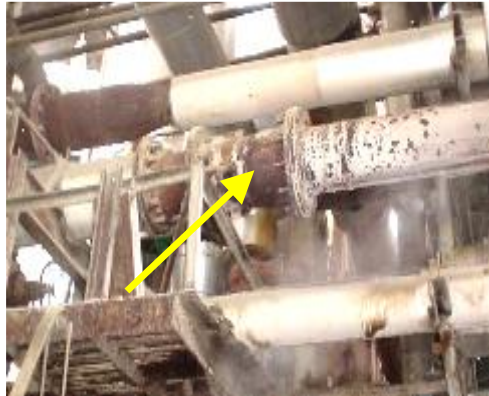
FIGURA 8.8 LÍNEAS DE DISTRIBUCIÓN DE VAPOR PARA EL TANDEM DE MOLINOS # 1 SIN AISLAR
