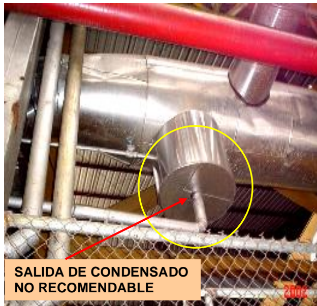
FIGURA 6.21 PIERNA COLECTORA INSTALADA EN LA LÍNEA DE SALIDA DEL TURBOGENERADOR TUBERÍA \phi 20"
