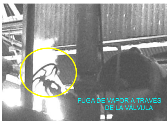
FIGURA 6.1 FUGA DE VAPOR EN VÁLVULA DE DISTRIBUCIÓN DE VAPOR
