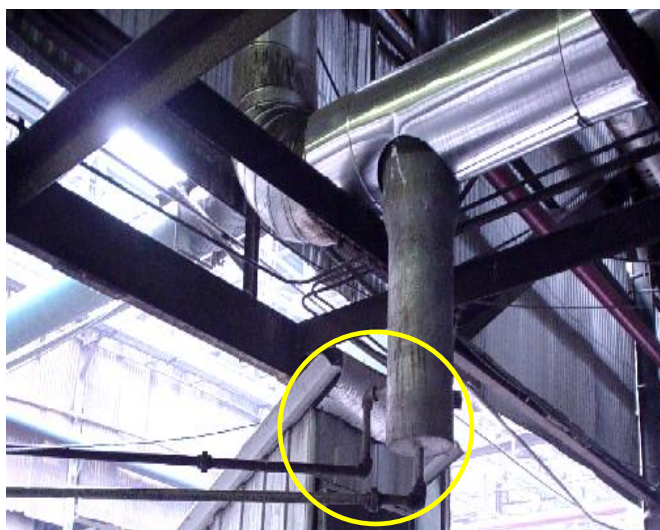
FIGURA 6.3 PRIMERA PIERNA COLECTORA UBICADA ENTRE EL CALDERO D8 Y EL CALDERO C9
