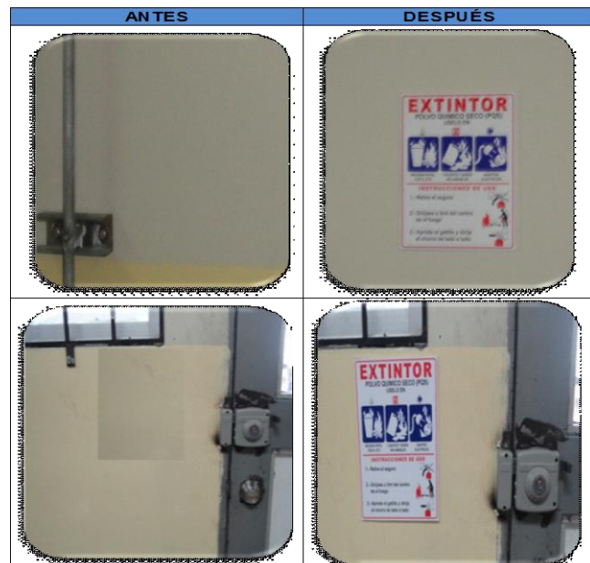
FIGURA 4.5. SEÑALES DE EXTINTORES
