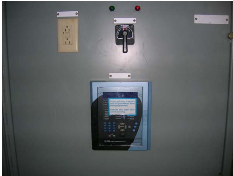
Figura 1.12 Relés de protección.
