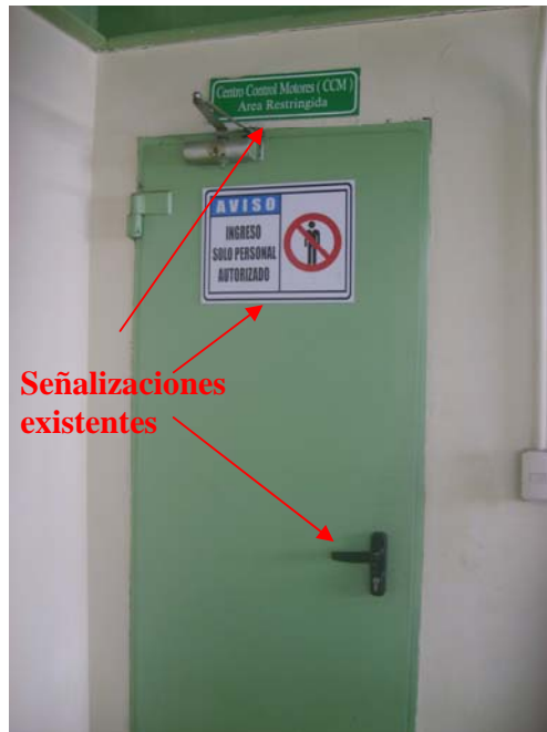
Figura 6.3 Puerta de acceso al CCM
