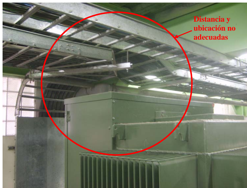
Figura 5.9 Distancia entre bandeja y transformador
