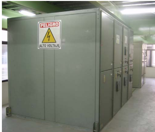
Figura 1.14 Celdas del Metalclad (switchgear)
