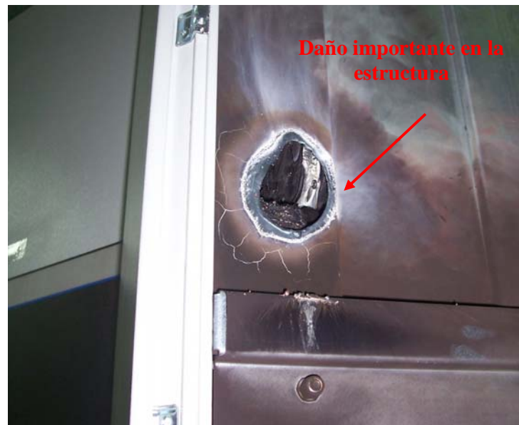
Figura 3.1 Efecto de un corto circuito en un variador de velocidad
