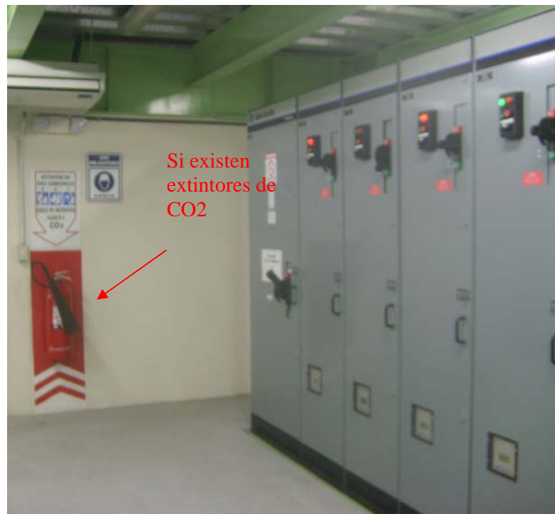
Figura 6.2 Centro de control de motores
