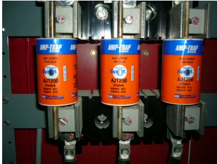
Figura 2.16 fusibles CCM casa de fuerza
