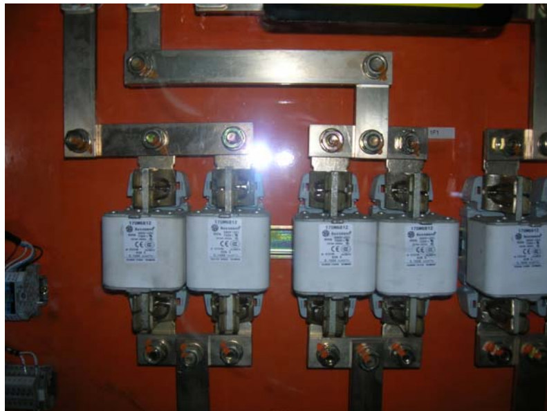
Figura 2.17 Fusible CCM Caldera
