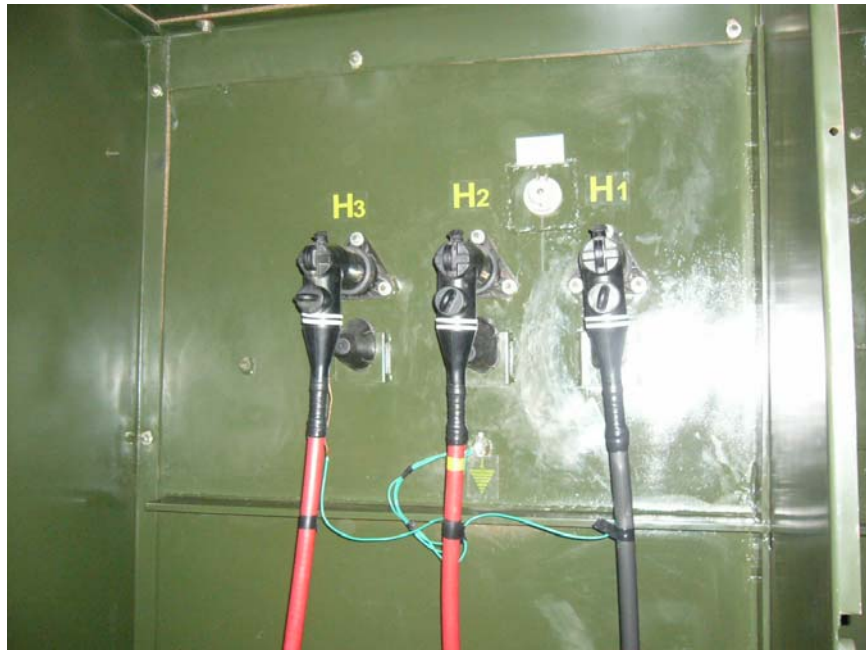
Figura 5.6 Terminales de lado de alta tensión
