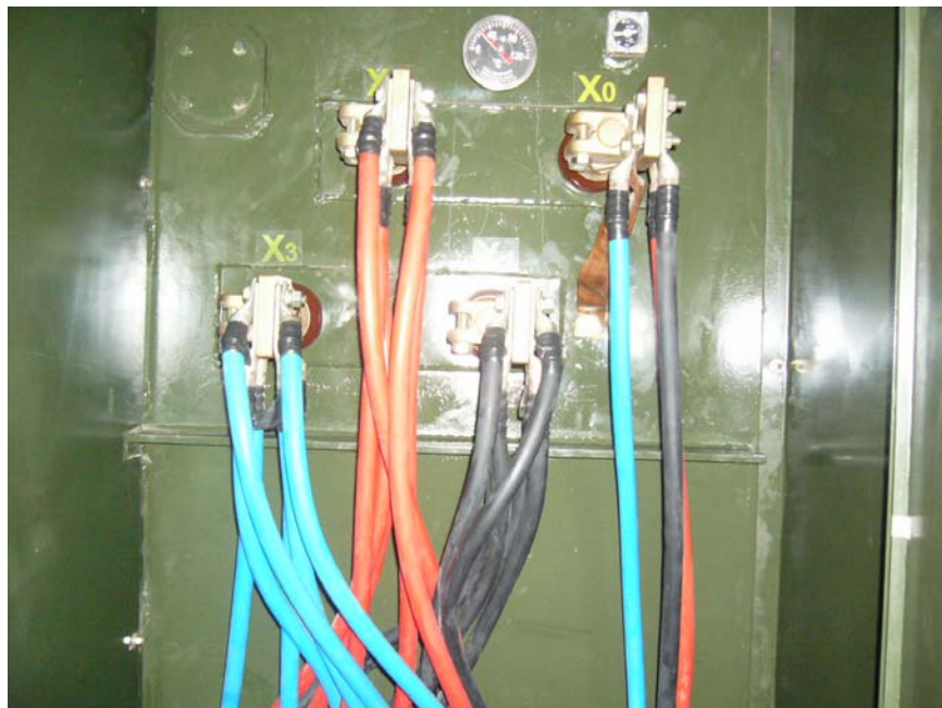
Figura 5.7 Terminales de lado de baja tensión
