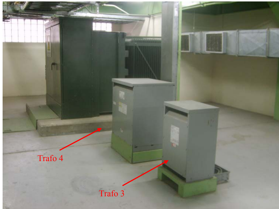
Figura 1.7 Cuarto de transformadores (transformadores secos).
