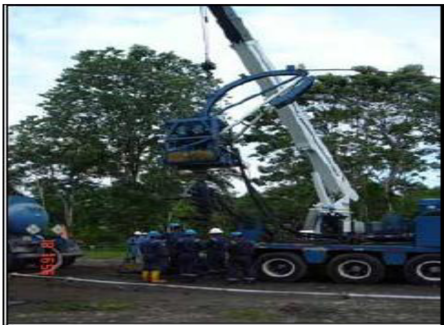
FIGURA 5.2: UNIDAD DE COILDED TUBING
