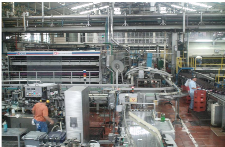
Figura 2.5 - PASTEURIZADOR Y ETIQUETADORA
