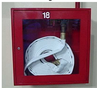
FIGURA 4.11 – MANGUERAS DE SERVICIO CONTRA INCENDIO
