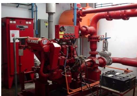
FIGURA 4.5 – CUARTO DE EQUIPOS DE BOMBEO
