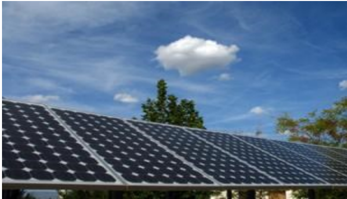
Figura 1.1 Arreglo de paneles fotovoltaicos
