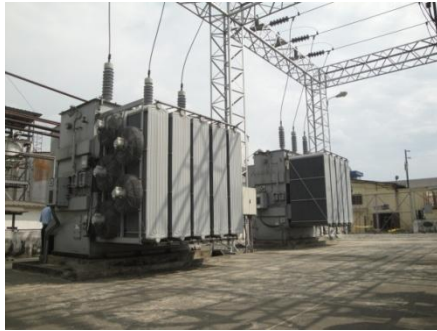
Figura 2.2: Transformadores de Potencia de Subestación ECUDOS
