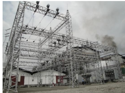
Figura 2.1: Subestación del Ingenio ECUDOS
