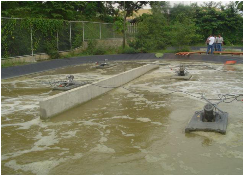
Digestor: confinamiento y reducción final de lodos.
