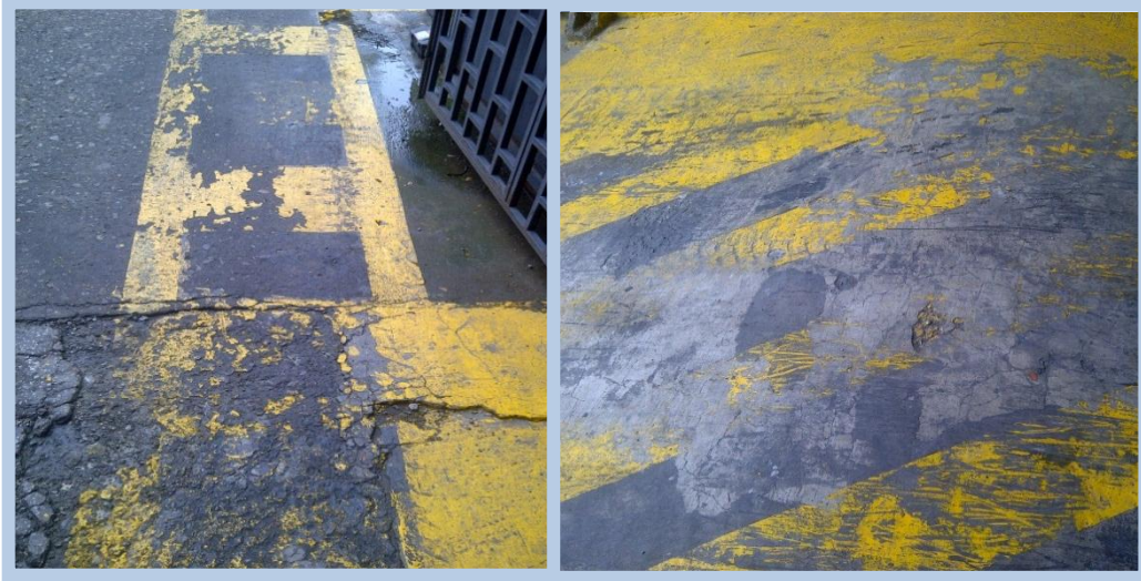
Foto 17 SEÑALIZACIÓN POCO VISIBLE
