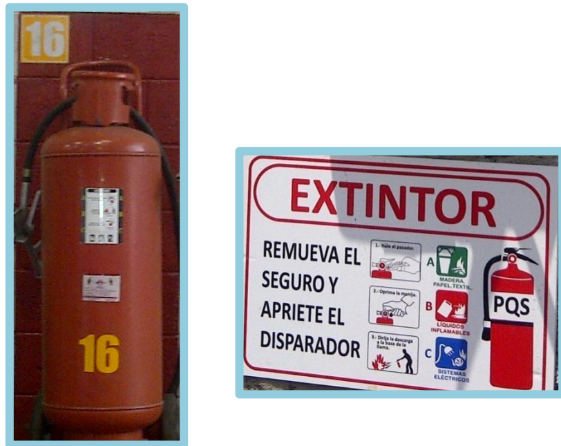
Foto 13 EXTINTORES Y SEÑALÉTICAS
