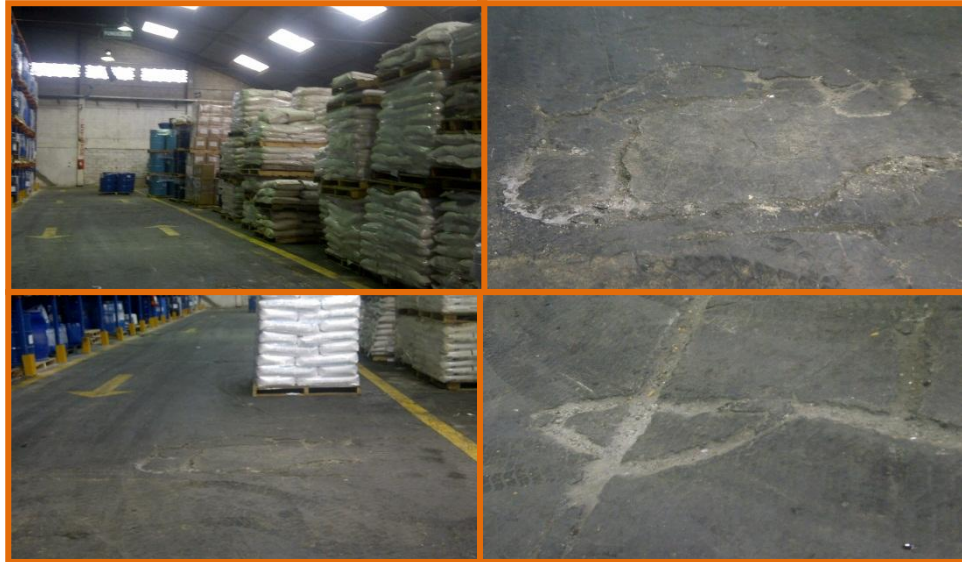
Foto 14 Piso con Fisuras en Bodega de Materia Prima
