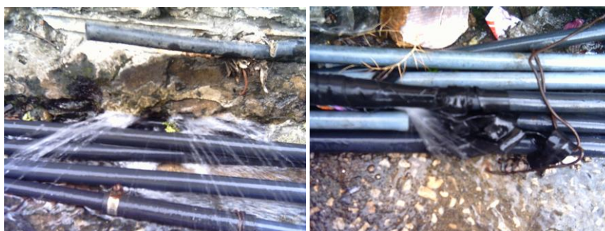
Foto 1 Callejón 12 de octubre, fugas visibles cada 2 m (roturas de mangueras)
