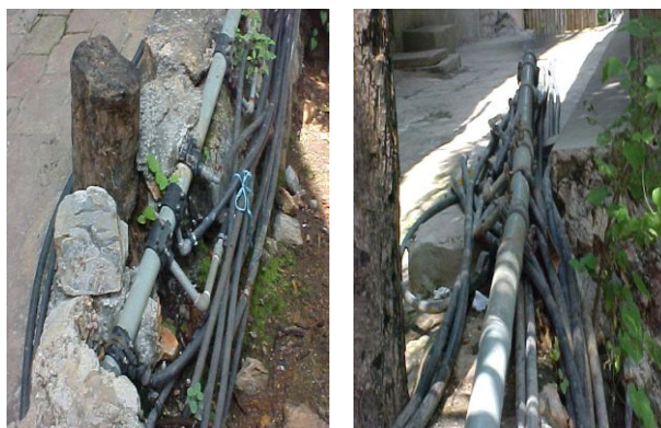
Foto 2 9no. Callejón, conexión ilegal de 30 mangueras de 1/2" a una tubería P.V.C de 2".
