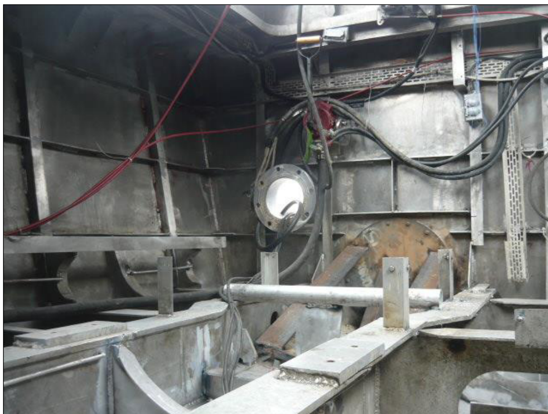
Figura No. 3 Vista de la zona de Sala de Máquinas de la lancha “Guayas”,
