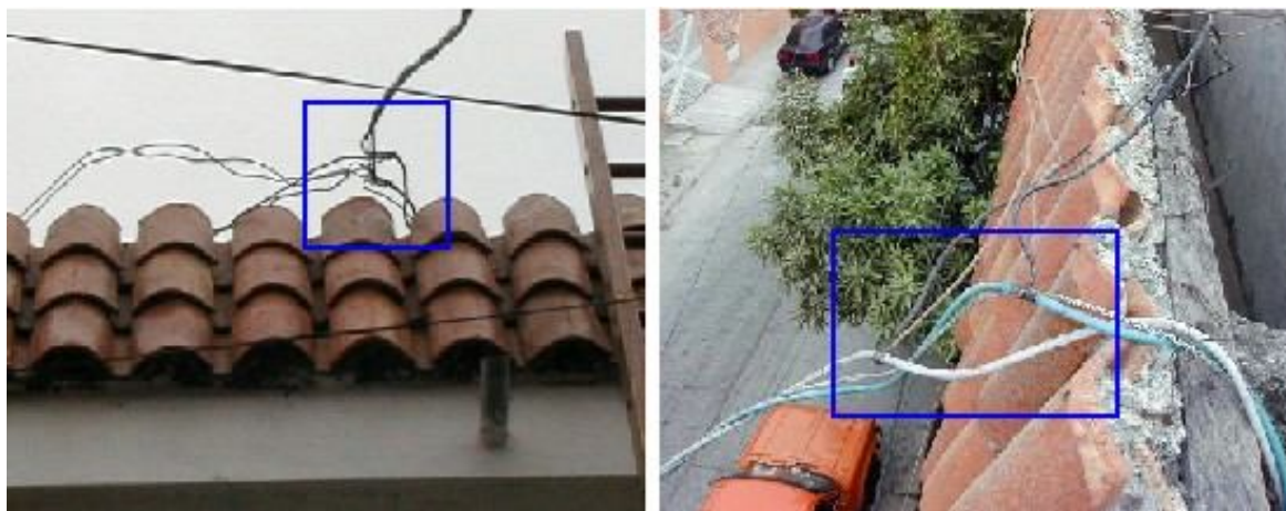
Fig. No. 1.1, derivaciones evidentes en los conductores de servicio, del tipo fija.
