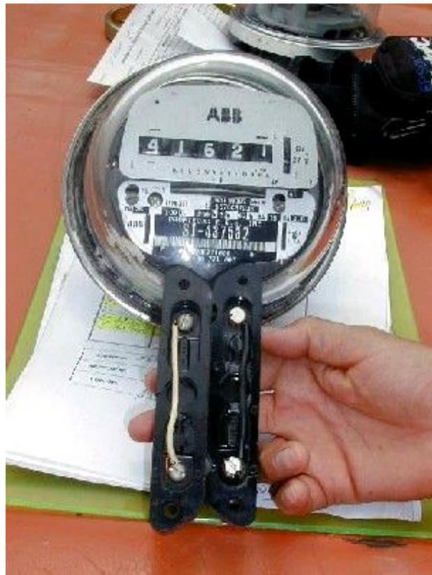
Fig. No. 1.6, derivaciones ocultas en el socket del medidor. Se aprecian las dos baquelitas retiradas de la base socket con los respectivos puentes fraudulentos, que permiten efectuar la desviación de una parte de la energía consumida.
