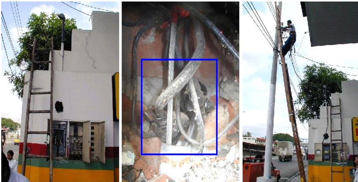
Fig. No. 1.3, derivaciones ocultas sin manejo de carga: se puede apreciar que los conductores de derivación ilegal, parten de los conductores de servicio por medio de "perno partido aislado" tipo fijo.
