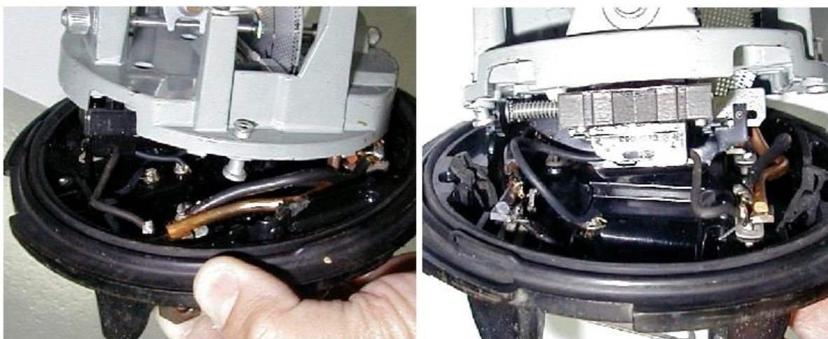
Fig. No. 2.4 alteración eléctrica en la(s) bobina(s) de corriente, utilizando para el efecto un alambre conductor, conectado en paralelo con la(s) bobina(s) de corriente.
