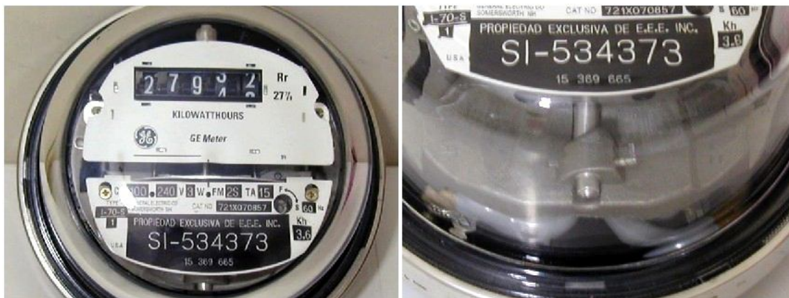
Fig. No. 2.5 alteración eléctrica en la(s) bobina(s) de corriente; izquierda: medidor de energía eléctrica tipo socket monofásico CI-100, características mecánicas corresponden a sus especificaciones de fábrica; derecha: se aprecia que las bobinas de corriente no corresponden a las especificaciones de fábrica, corresponden a un medidor de energía eléctrica del tipo socket monofásico CI-200, este equipo sólo registrará el 50%.
