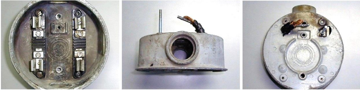
Fig. No. 1.8, derivaciones ocultas en el socket del medidor; sin manejo de carga, utilizando para el efecto tornillos y conductores en la parte posterior de la base socket, permitiendo efectuar la desviación de una parte de la energía consumida. La detección del fraude en el presente caso, es un tanto compleja, por cuanto no existe voltaje entre los terminales de carga y el neutro del sistema eléctrico, aparentando que la instalación está “limpia” de fraude. Sin embargo, la detección de la derivación ilegal, depende mucho de la acuciosidad y el cuidado que el instalador de medidores realice en la revisión.
