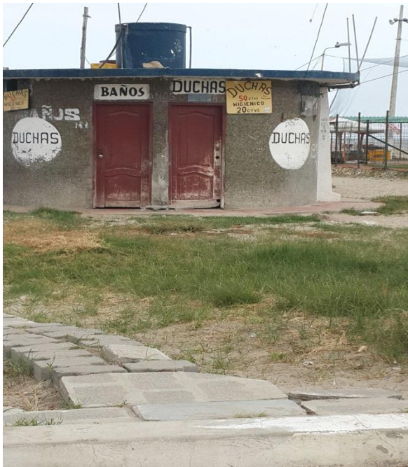
Figura 21 Baños Públicos en mal estado
