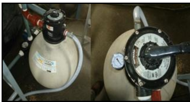
FIGURA 4.5 FILTRO DE ARENA
