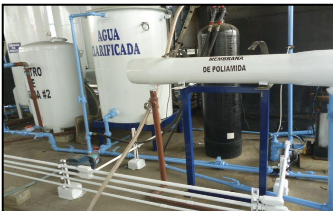
FIGURA 4.8 TANQUES DE PASO DE AGUA RESIDUAL
