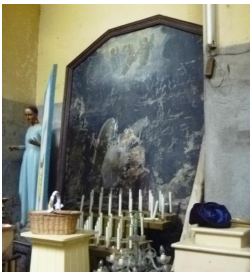
Foto No. 24: Antiguo cuadro destruido por filtraciones de agua.
