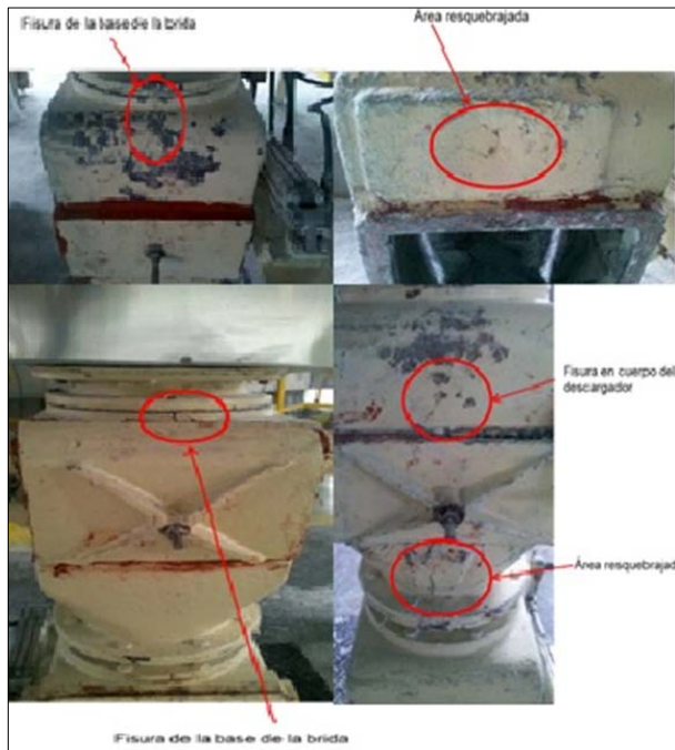
FIGURA 21.DAÑOS DE LOS DESCARGADORES.
