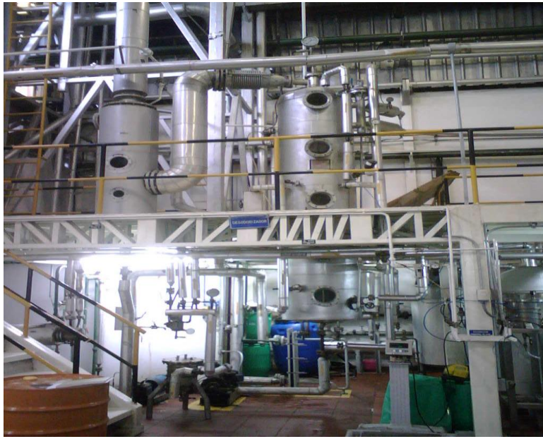
Imagen #1: Torres de destilación
