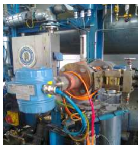
FIGURA 4.2 CONTROLADOR DE TEMPERATURA DEL COMBUSTIBLE.
