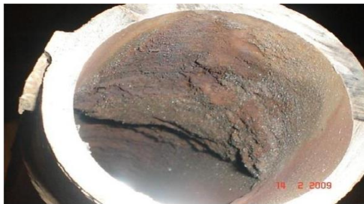
FIGURA 2.7 FALLA POR CORROSIÓN CAUSTICA
