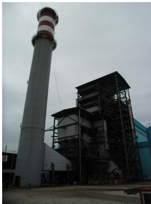
FIGURA 1.1 CENTRAL TÉRMICA TRINITARIA.
