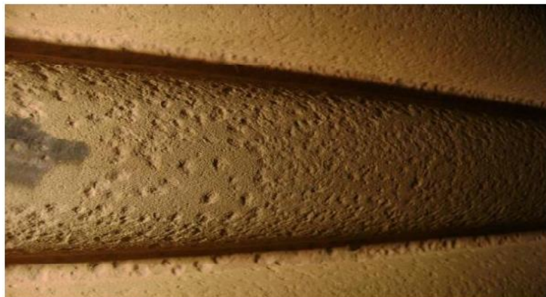
FIGURA 2.13 MECANISMO FALLA POR CORROSIÓN.
