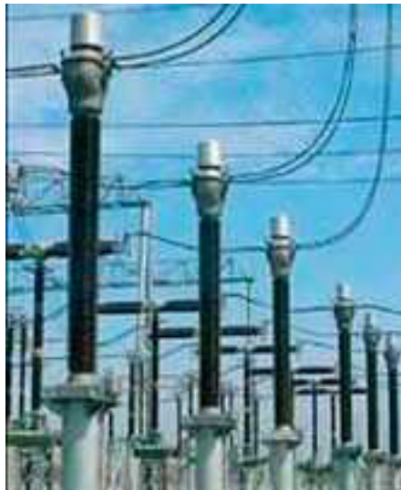
Gráfico 35 Transformadores de corriente
