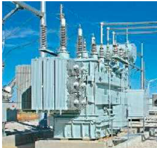
Gráfico 29 Transformador de Potencia 150MVA
