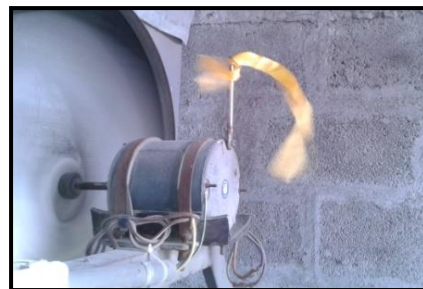
FIGURA 7.29 CONTROL VISUAL DE GIRO DE MOTORES DEL CONDENSADOR
