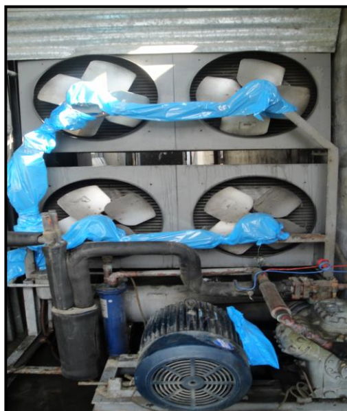
FIGURA 7.9 PARTES ELÉCTRICAS IMPERMEABILIZADAS
