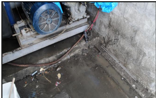
FIGURA 7.10 CONDICIONES SUB-ESTÁNDARES EN CABLES ELÉCTRICOS 1
