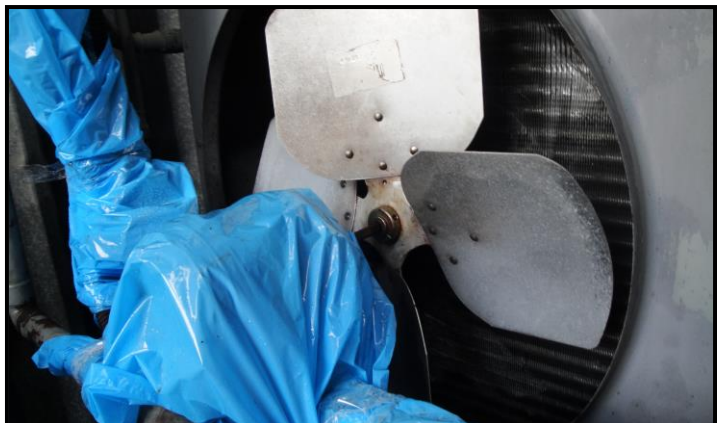
FIGURA 7.12 VENTILADOR DEL CONDENSADOR SIN GUARDA
