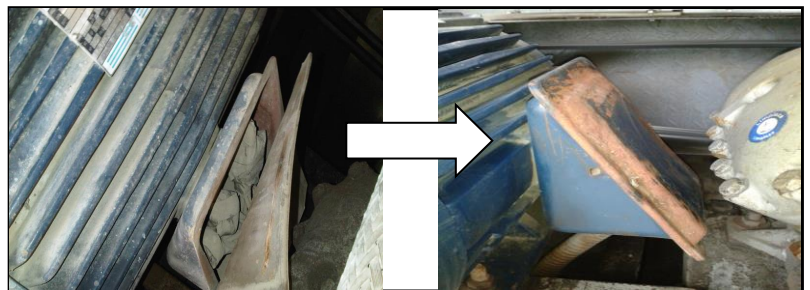
FIGURA 7.21 ANTES Y DESPUÉS DE TAPA DE CONEXIONES DEL MOTOR
