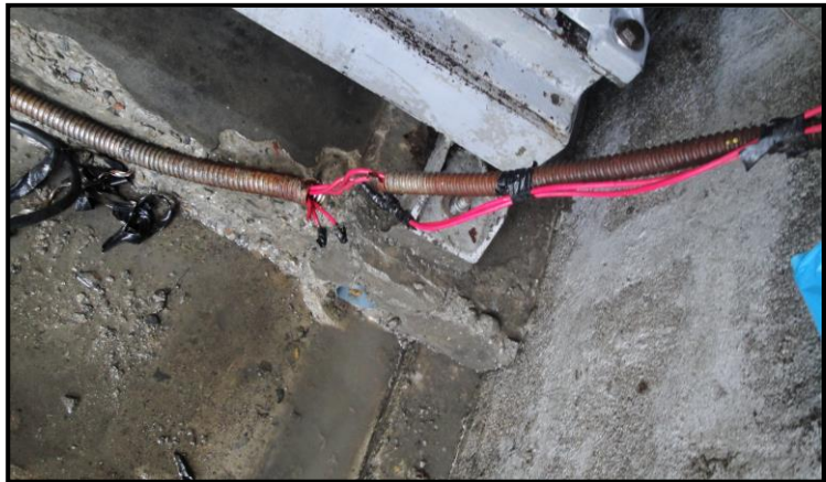
FIGURA 7.11 CONDICIONES SUB-ESTÁNDARES EN CABLES ELÉCTRICOS 2
