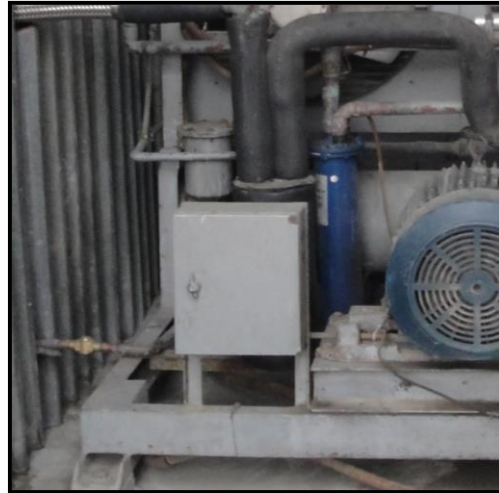
FIGURA 7.15 CAJA INUTILIZADA DIFICULTA ACCESO EN LIMPIEZA
