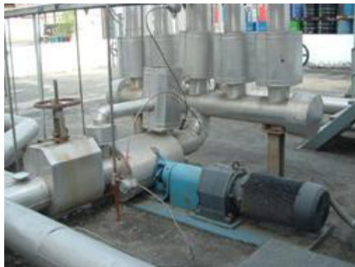
Zona de recirculación y envío a Gantry
