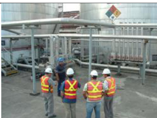
Zona de Tanques
