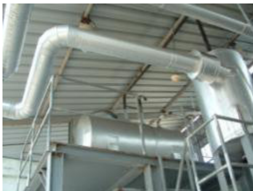
Tanque de Expansión
