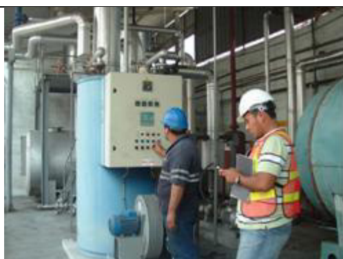
Zona de Caldera
