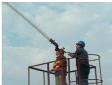
Pruebas del sistema contra incendio
