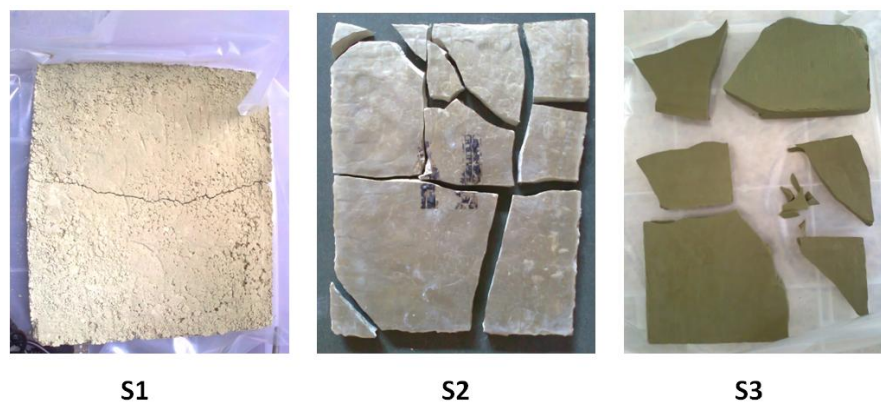
Figura 4.7. Grietas de los techos de geopolímeros.
