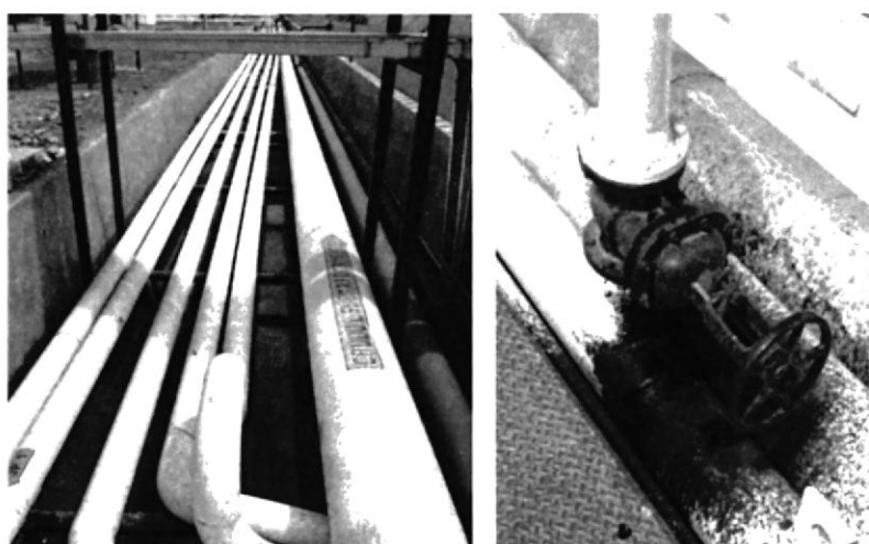
Figura 6.3: Contaminación por lı́quidos en uniones bridadas y válvulas
