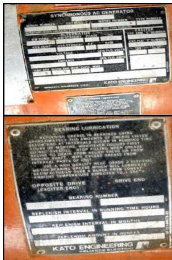
FIGURA 1.3 PLACAS DE IDENTIFICACIÓN DE MOTOR-GENERADOR N°4.
