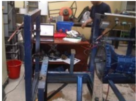
Motor desmontado del grupo de bombeo
