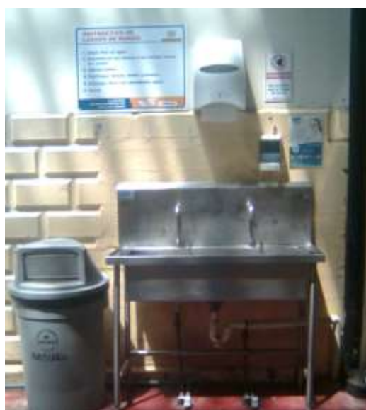
Lavamanos colocado antes del ingreso del área.
