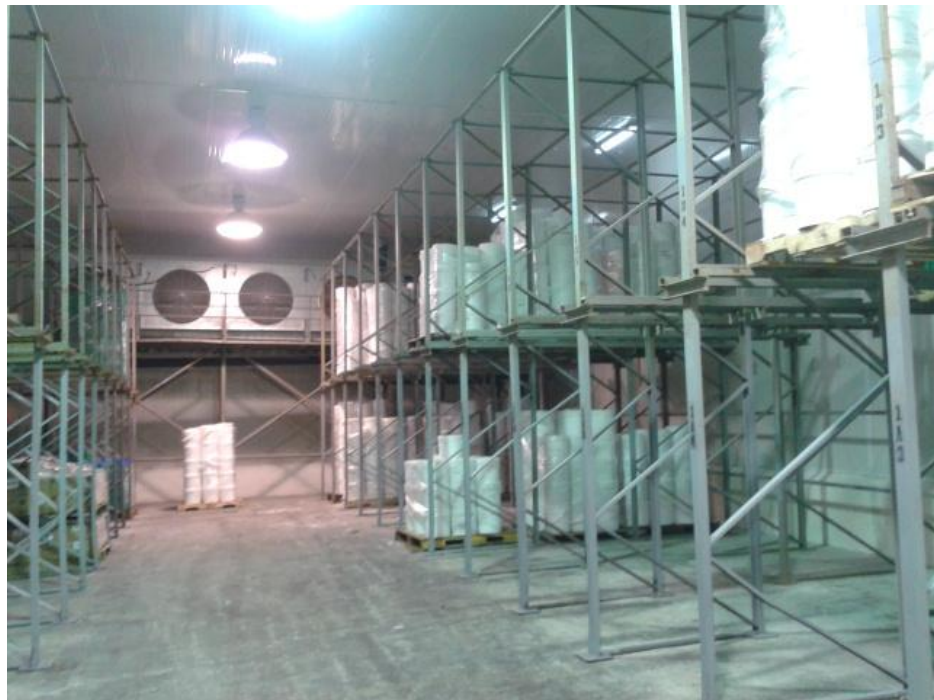
FIGURA 2.14. CÁMARAS DE CONSERVACIÓN DE CONGELADOS.
