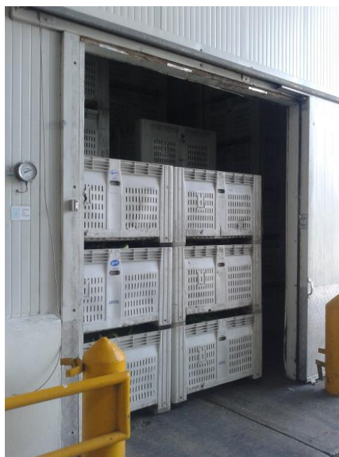
FIGURA 2.4. CÁMARAS DE MADURACIÓN.
