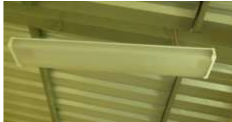
Figura 3.5 Protector de lámpara instalado.
