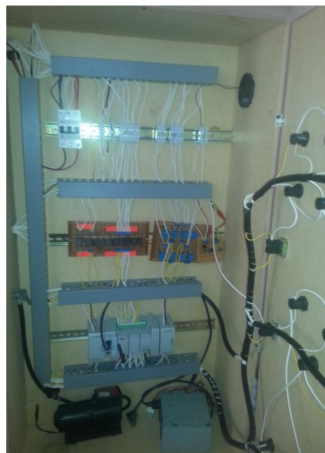
Figura 9. Conexiones del panel de control.
