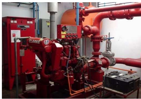
FIGURA 4.5 – CUARTO DE EQUIPOS DE BOMBEO
