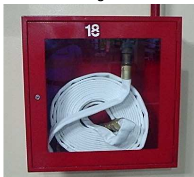
FIGURA 4.11 – MANGUERAS DE SERVICIO CONTRA INCENDIO
