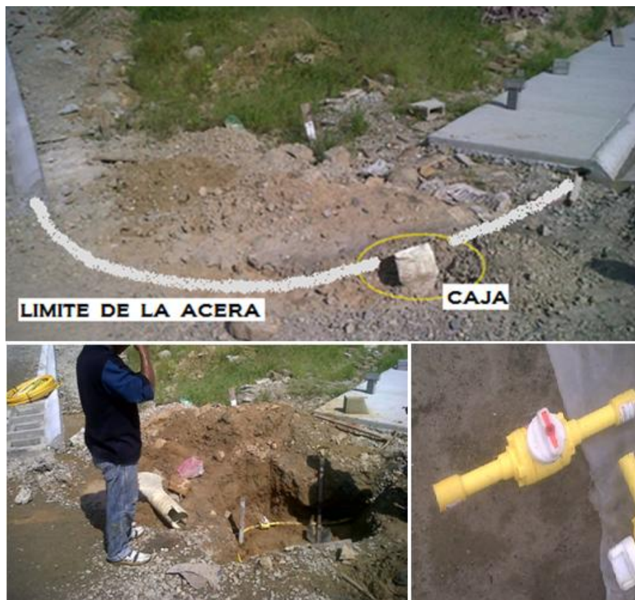
FIGURA 30: DAÑOS Y REPARACIONES DE POLIVÁLVULAS
