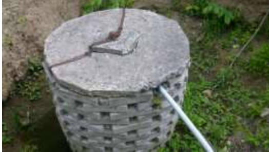
Pozo del comité de agua “Unión y Progreso”, La Unión
