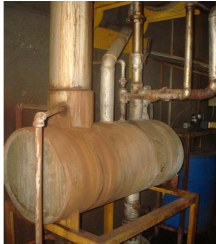
FIGURA 3.14 TANQUE RECOLECTOR DE CONDESADOS DE LA PLANTA
