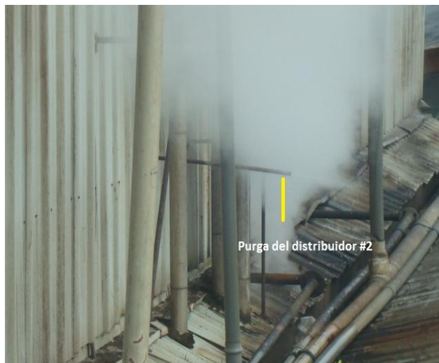
FIGURA 3.16 DESCARGA DE CONDENSADO DEL DISTRIBUIDOR #2
