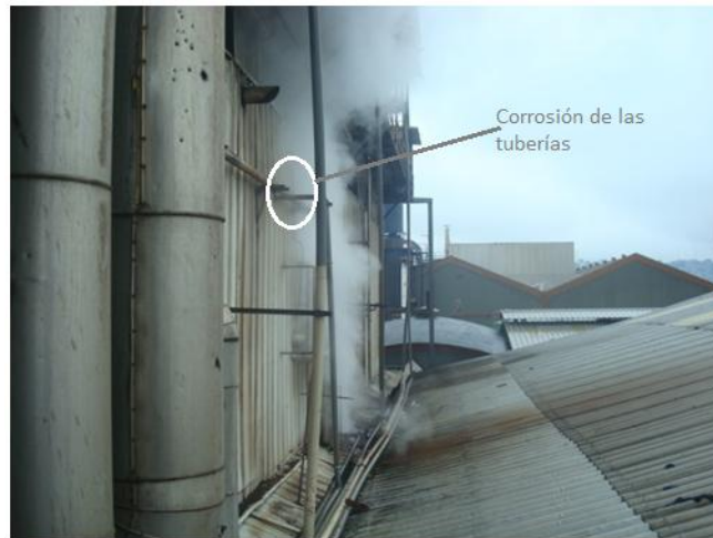
FIGURA 3.13 PÉRDIDA DE VAPOR AL AMBIENTE
