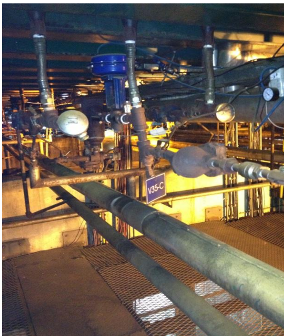
FIGURA 3.20 INSTALACIONES DE VAPOR Y RETORNO DE CONDENSADO DE LAS BANDEJAS DE SECADO
