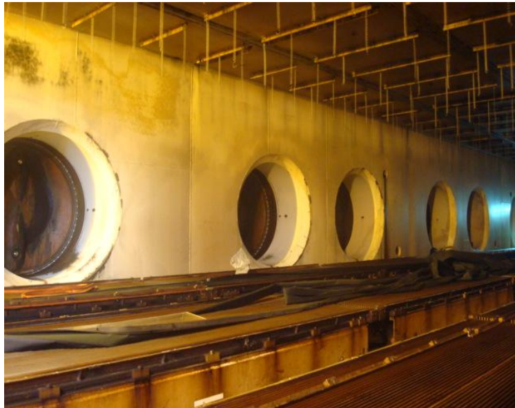
FIGURA 2.11 LAS 6 VÁLVULAS TIPO MARIPOSA QUE CONECTAN LA CÁMARA DE VACÍO CON LOS CONDENSADORES
