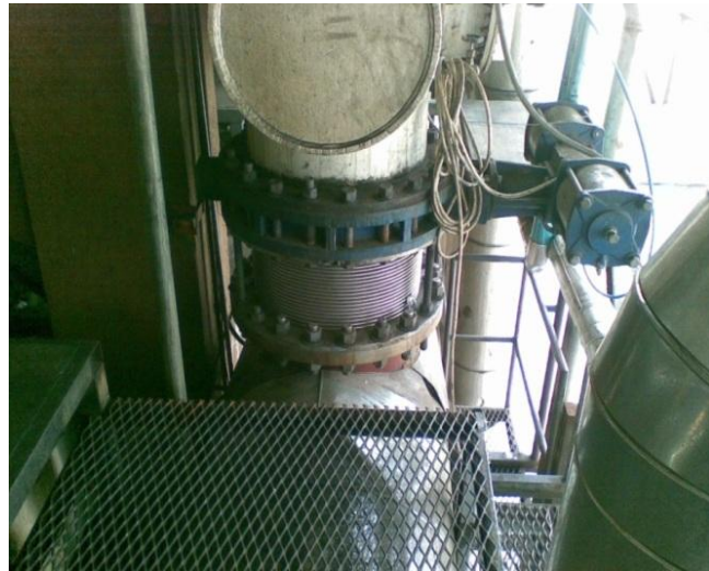
FIGURA 2.5 JET # 1 CONECTADO A LA TUBERÍA PRINCIPAL DE VACÍO
