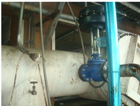
FIGURA 2.6 VÁLVULA DE CONTROL PROPORCIONAL QUE INYECTA VAPOR A LA TUBERÍA DE VACÍO
