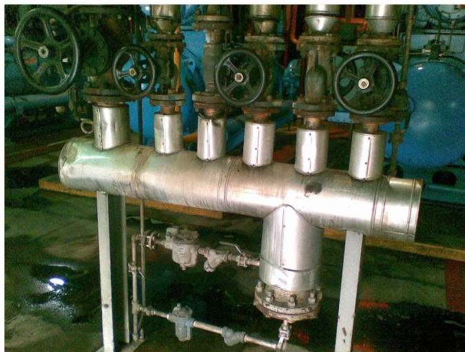
FIGURA 3.6 DISTRIBUIDOR DE VAPOR #3
