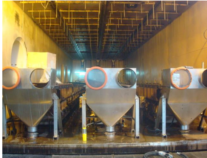
FIGURA 3.17 VISTA DE LAS TRES LÍNEAS DE SECADO DE PRODUCTO AL INTERIOR DE LA CÁMARA DE VACÍO
