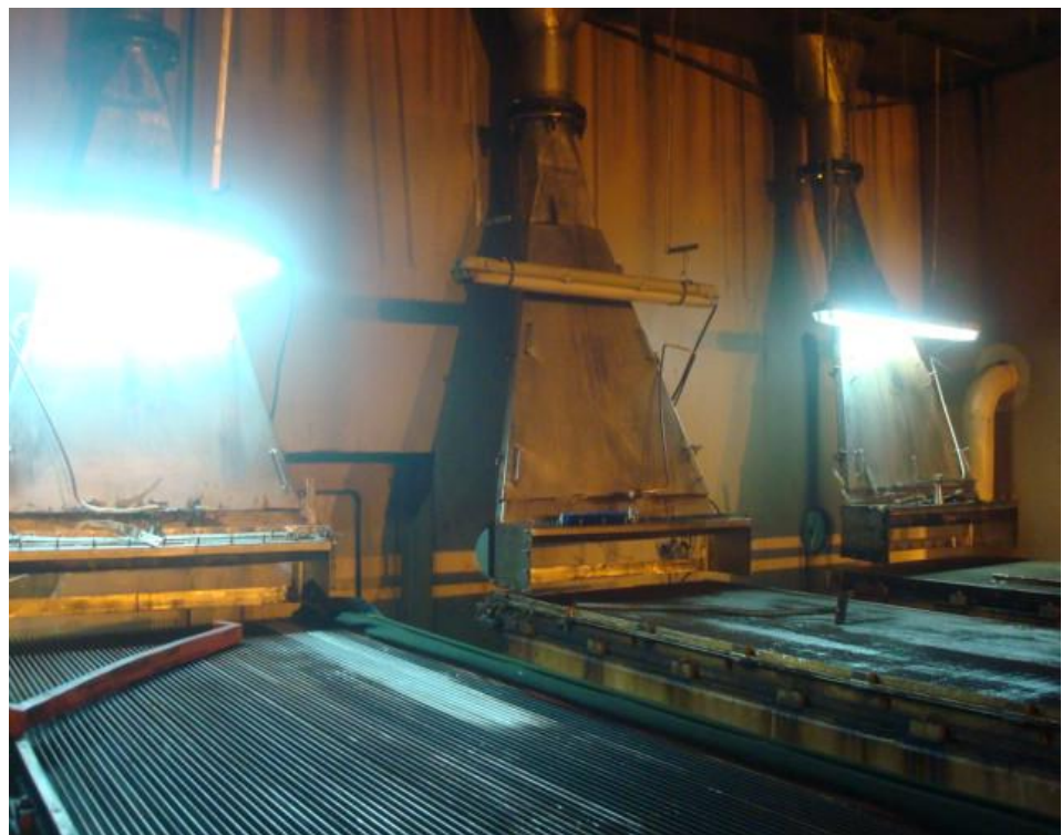
FIGURA 2.2 TOLVAS DE DESCARGA Y BANDEJAS DE SECADO AL INTERIOR DE LA CÁMARA DE VACÍO
