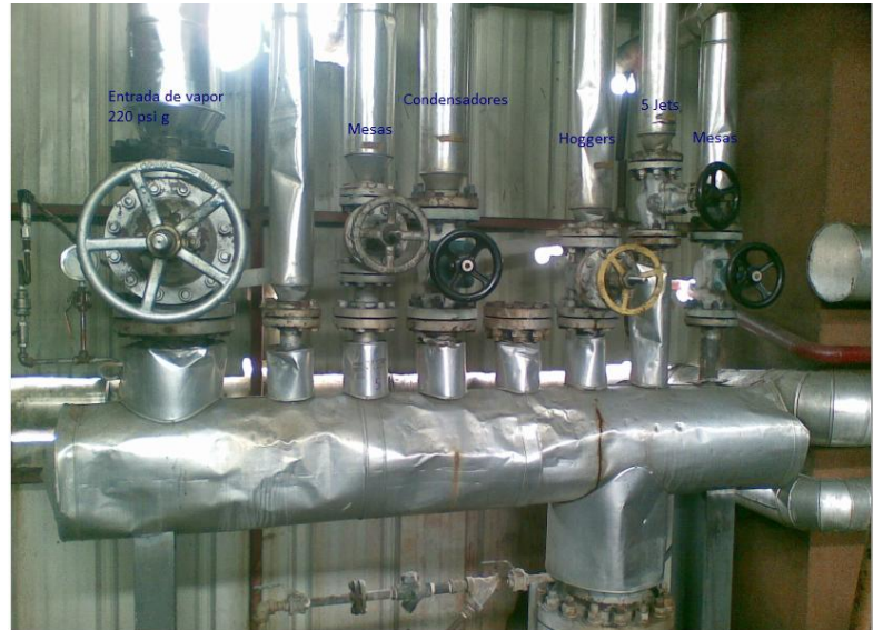
FIGURA 3.5 DISTRIBUIDOR DE VAPOR # 2
