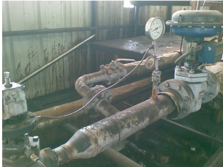
FIGURA 3.22 DERIVACIÓN TOMADA DE LA LÍNEA DE VAPOR DE LOS CONDENSADORES
