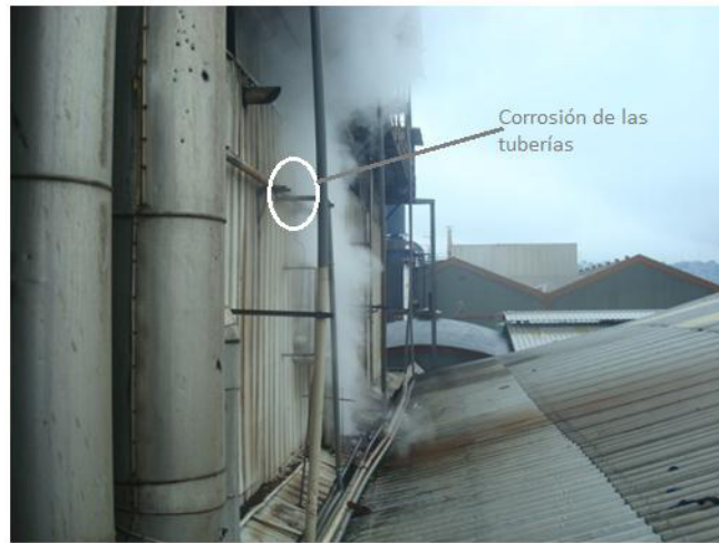
FIGURA 3.13 PÉRDIDA DE VAPOR AL AMBIENTE
