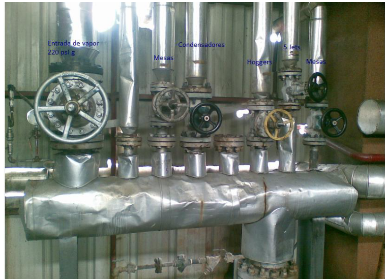
FIGURA 3.5 DISTRIBUIDOR DE VAPOR # 2
