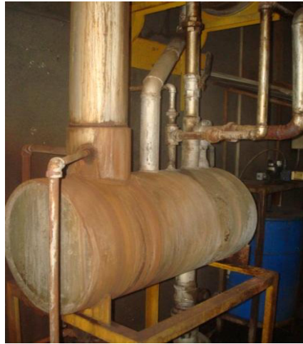
FIGURA 3.14 TANQUE RECOLECTOR DE CONDESADOS DE LA PLANTA
