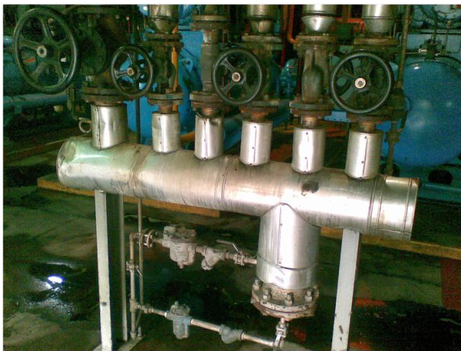
FIGURA 3.6 DISTRIBUIDOR DE VAPOR #3
