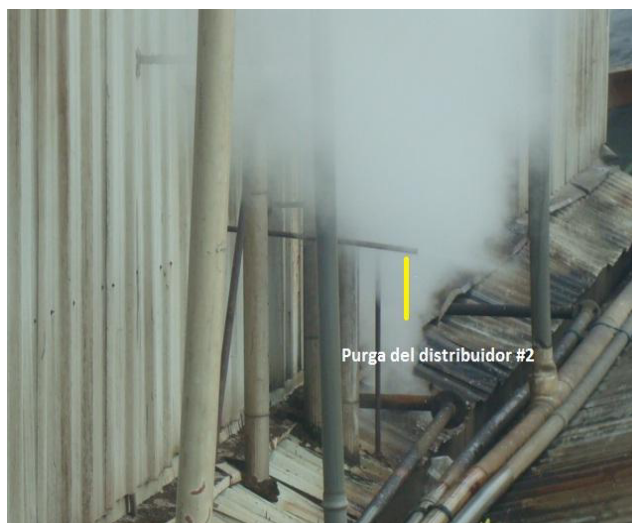
FIGURA 3.16 DESCARGA DE CONDENSADO DEL DISTRIBUIDOR #2
