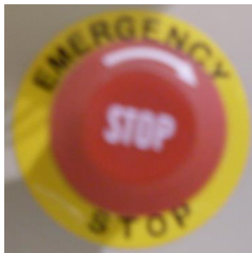
FIGURA 3.9 Paro de Emergencia
