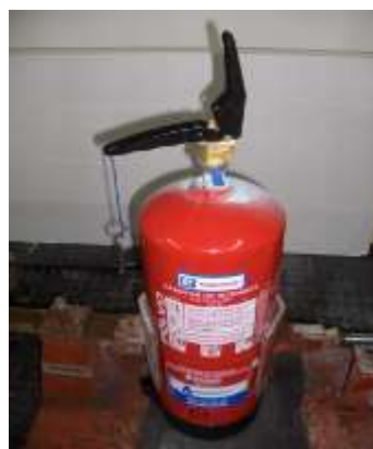
FIGURA 7.4 EXTINTOR CON LA VÁLVULA DESENROSCADA.
