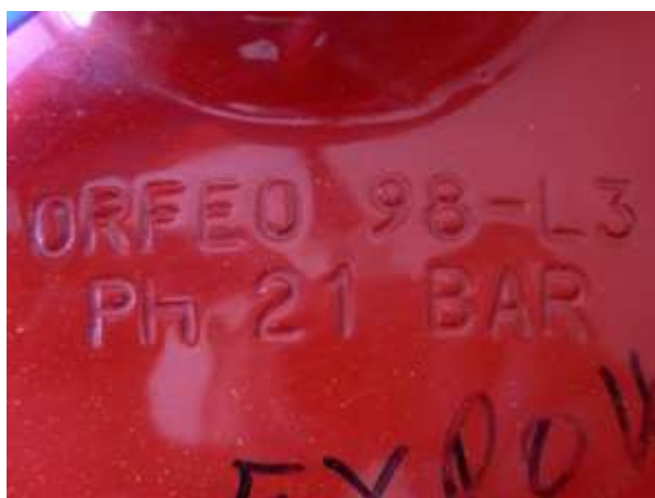
FIGURA 7.3 MARCADO PH SOBRE EXTINTOR
