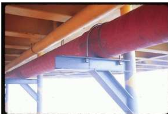
FIGURA 6.1 SOPORTE TUBERÍA SISTEMA CONTRA INCENDIO
