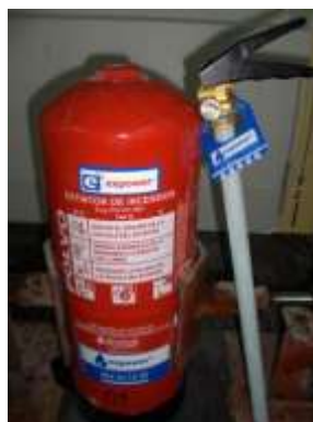
FIGURA 7.10 EXTINTOR RETIMBRADO CON SU VÁLVULA.
