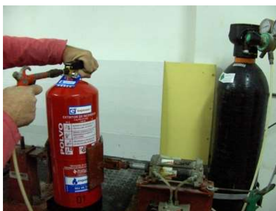
FIGURA 7.11 RECARGA MANUAL DE NITRÓGENO.
