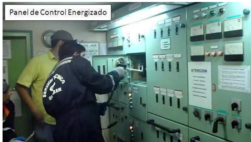
Figura 1.6 LIMPIEZA DE PANEL DE CONTROL.
