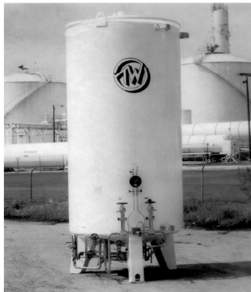
Figura 3.23 TANQUE VERTICAL DE ALMACENAMIENTO DE CO 2 .
