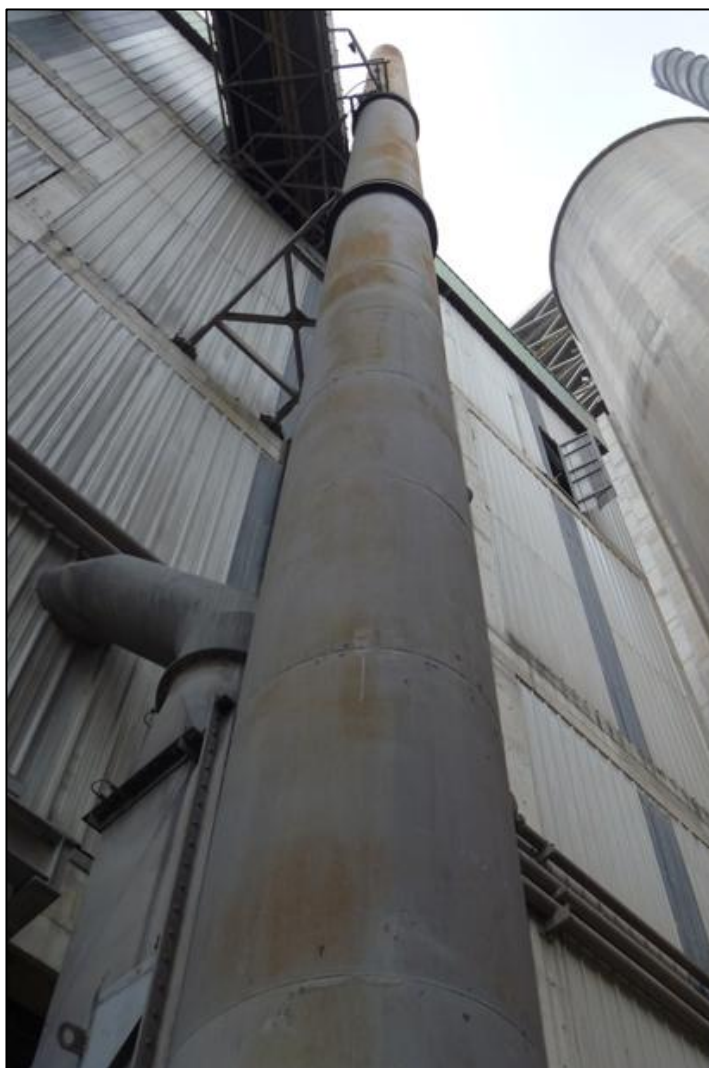
FIGURA 2.4. CORROSIÓN GENERALIZADA EN LA CHIMENEA
