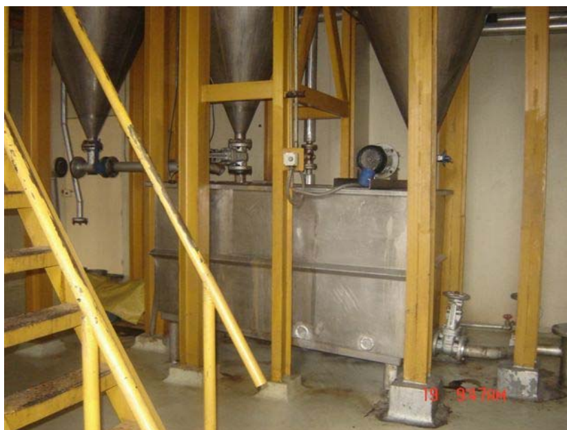
FIGURA 3. TANQUE ACONDICIONADOR DE MEZCLA
