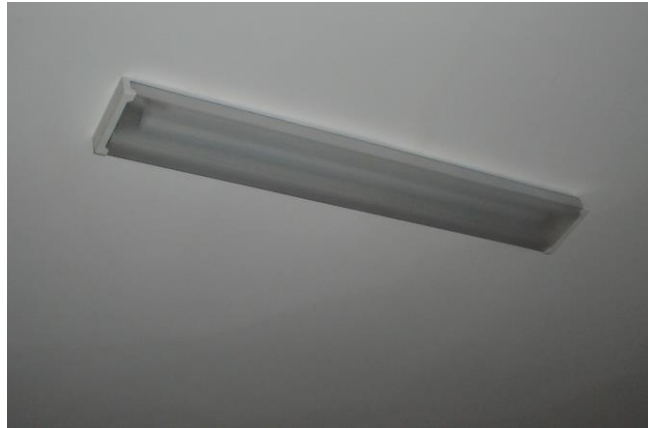
FIGURA 3.2 ILUMINACIÓN CON CUBIERTAS PROTECTORAS
