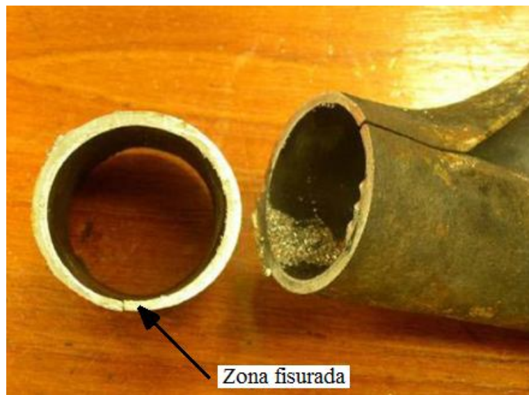
Figura 1.22 DISMINUCIÓN DE ESPESOR EN ZONA FISURADA
