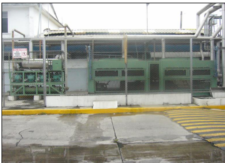
FIG. 2.15 UBICACIÓN DE CHILLERS
