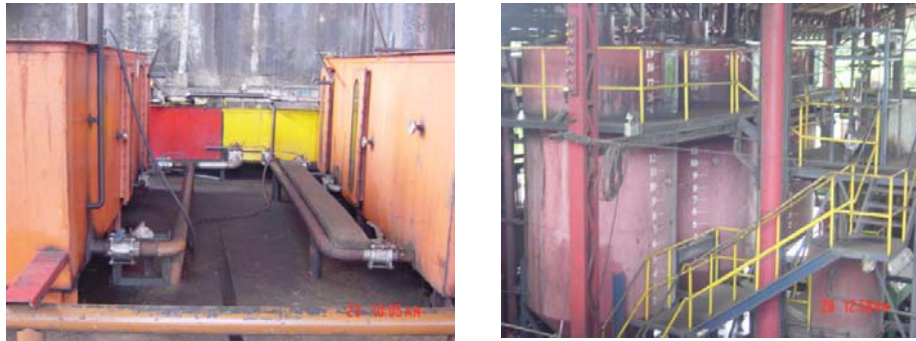
FIGURA 4.7 PRE-CLARIFICADORES Y CLARIFICADORES
