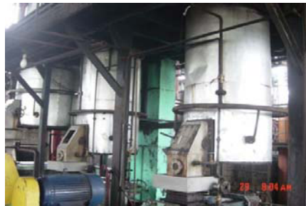
FIGURA 4.5 DIGESTOR DE 3 UNIDADES
