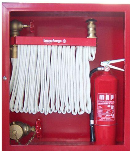
FIGURA 4.11.- CAJETÍN DE MANGUERAS CLASE III.
